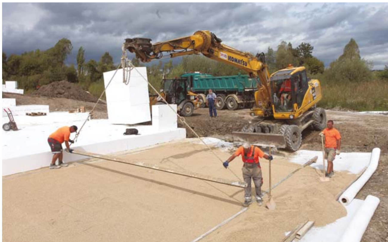
Noch gehen die Bauarbeiten voran: Hier wird an der zukünftigen Grünbrücke nahe der Einmündung zum Tierheim Material aufgeschüttet. Bis einschließlich zum Abzweig auf die Reichenau wird die Bundesstraße 33 auf jeden Fall vierspurig. Wie es mit dem Rest bis Allensbach weitergeht, ist umstritten. Auch die Finanzierung steht noch nicht. BILD: HANSE
